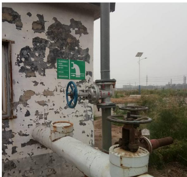
图 4-1 本项目污水总排口
