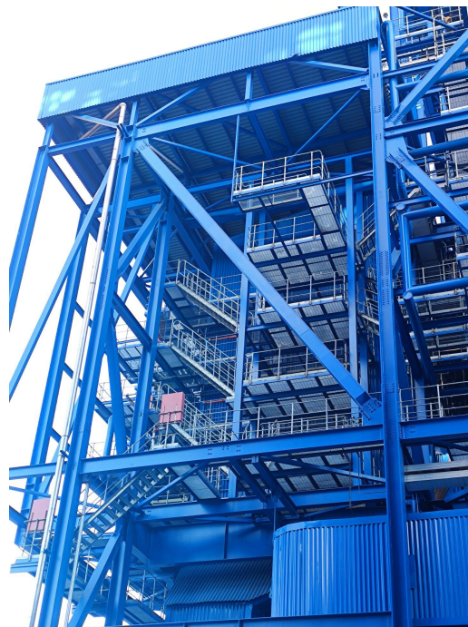
SCR 脱硝装置
